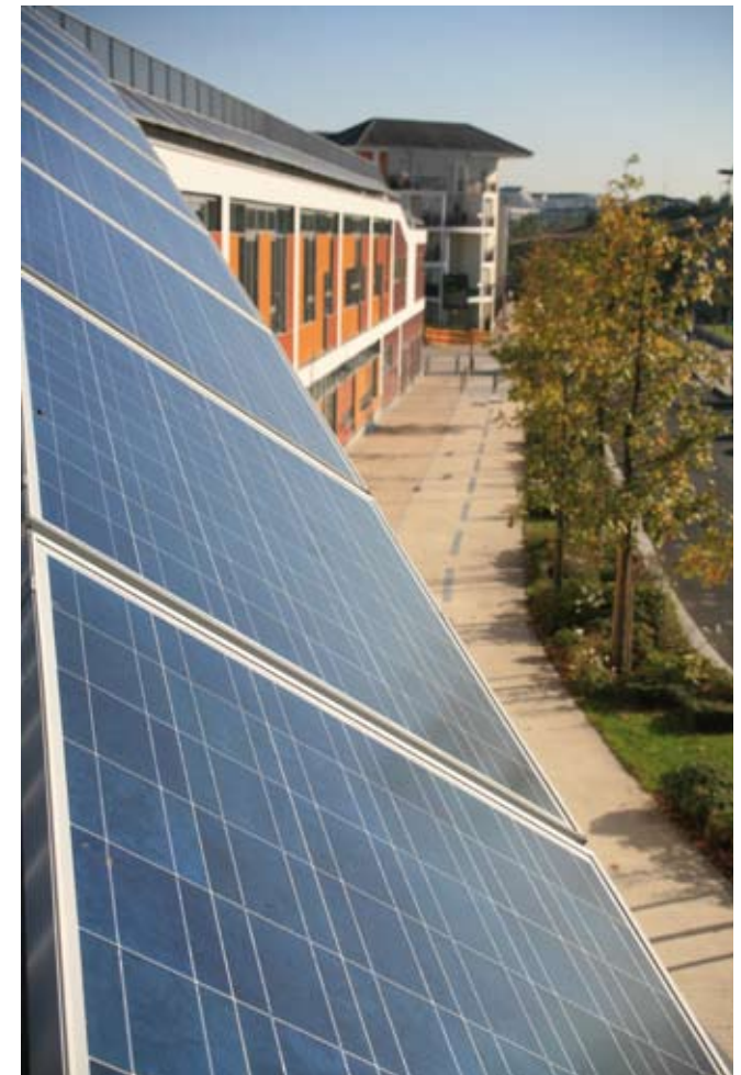
Maison de l'Enfance (panneaux photovoltaïques)
