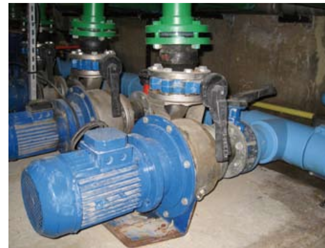
Station de pompage du lac
