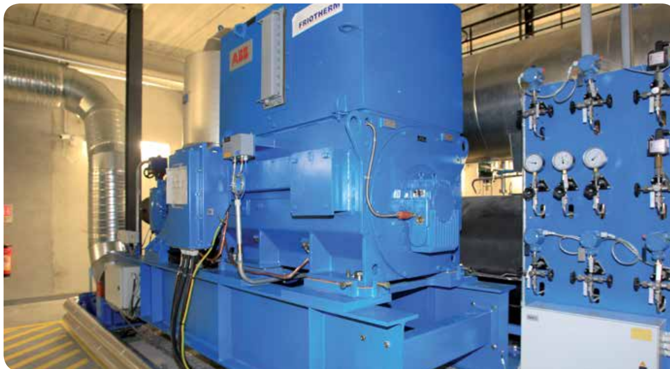
Les nouvelles pompes à chaleur
